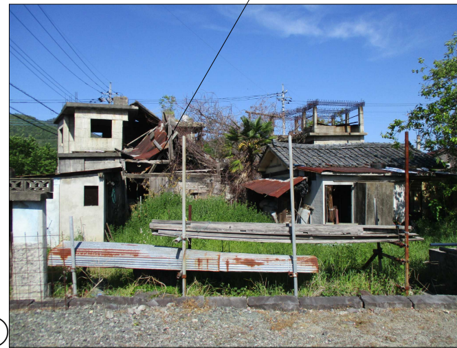
屋根崩落箇所
