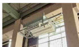
(体育館設置エアコン)
