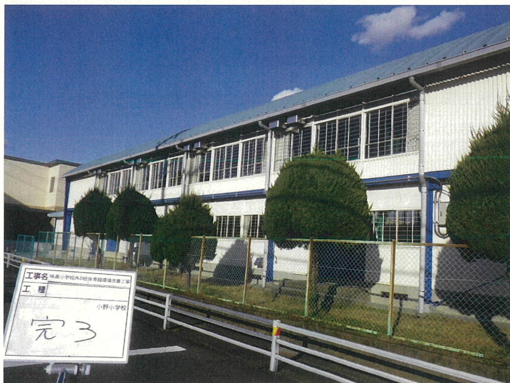
整備後：体育館換気設備（S造・外部）
