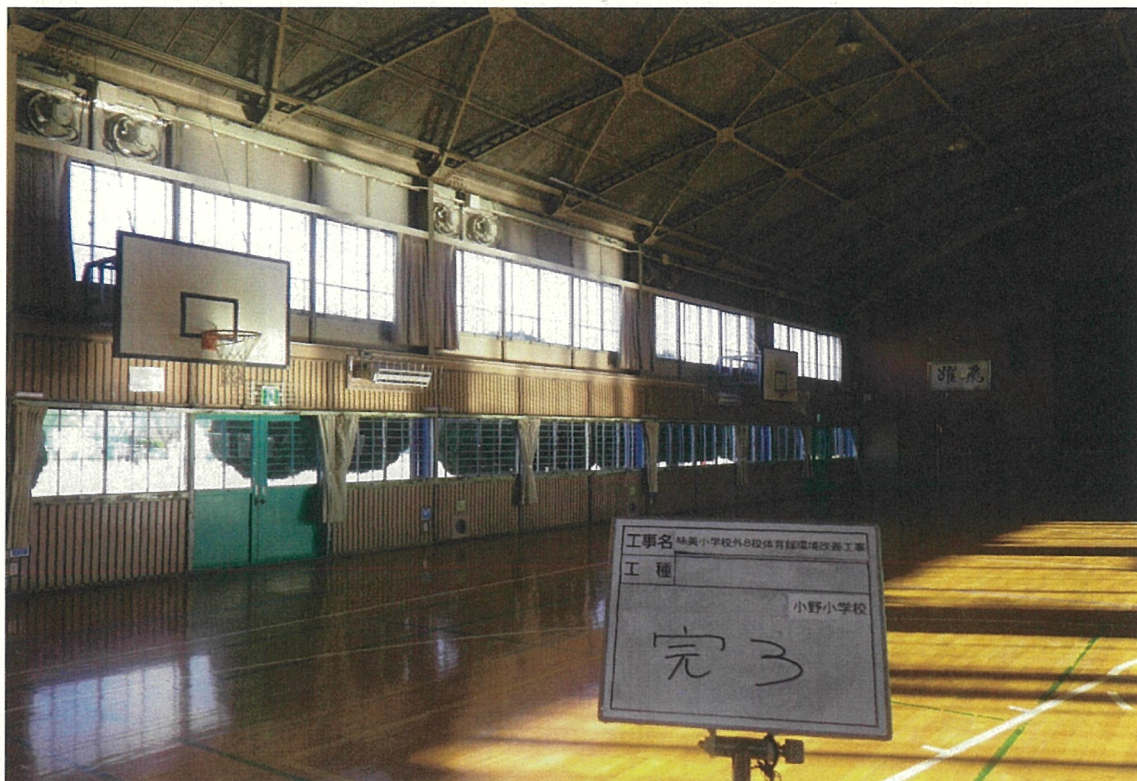
整備後：体育館換気設備（S造・内部）
