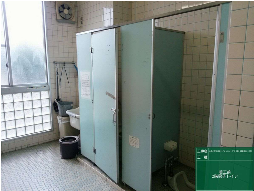
着工前 2階男子トイレ
