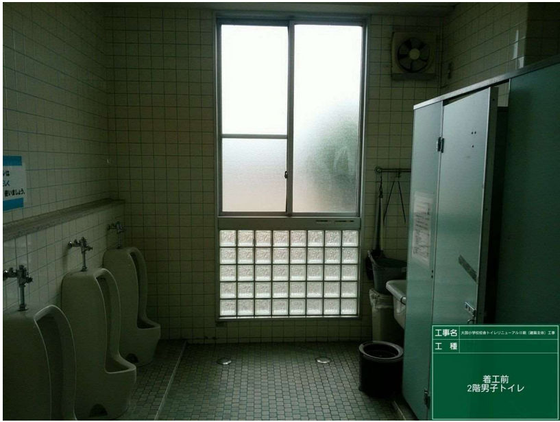
着工前 2階男子トイレ
