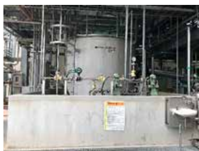
焼却炉1階のタンク
