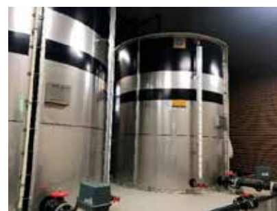
塩素滅菌棟のタンク
