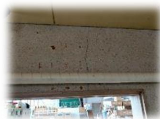
室内壁のクラック
