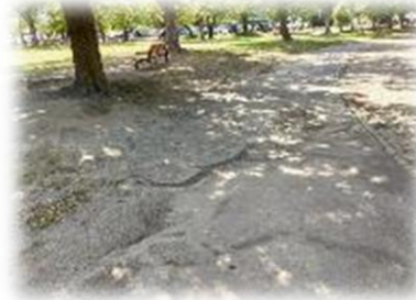
舗装のクラック
