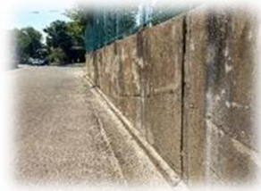
土留壁のクラック
