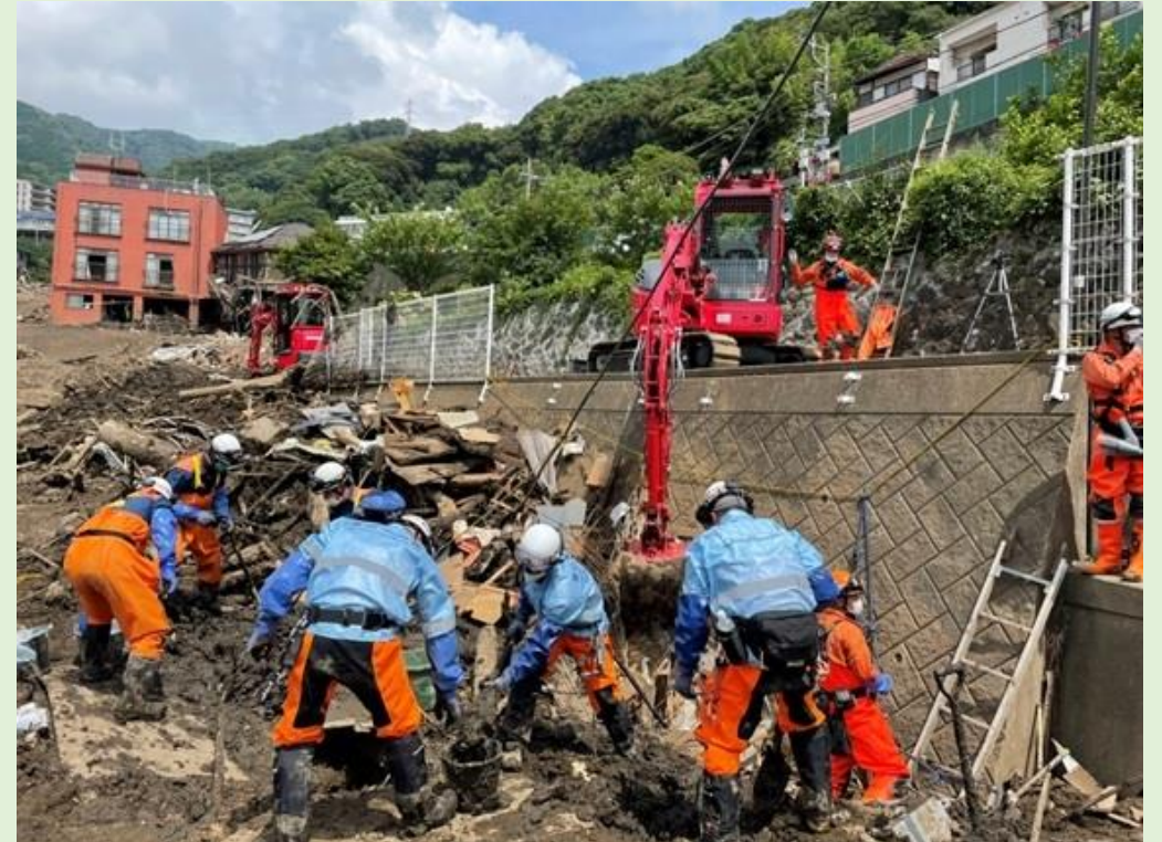
伊豆山の土石流（熱海市）令和3年7月
