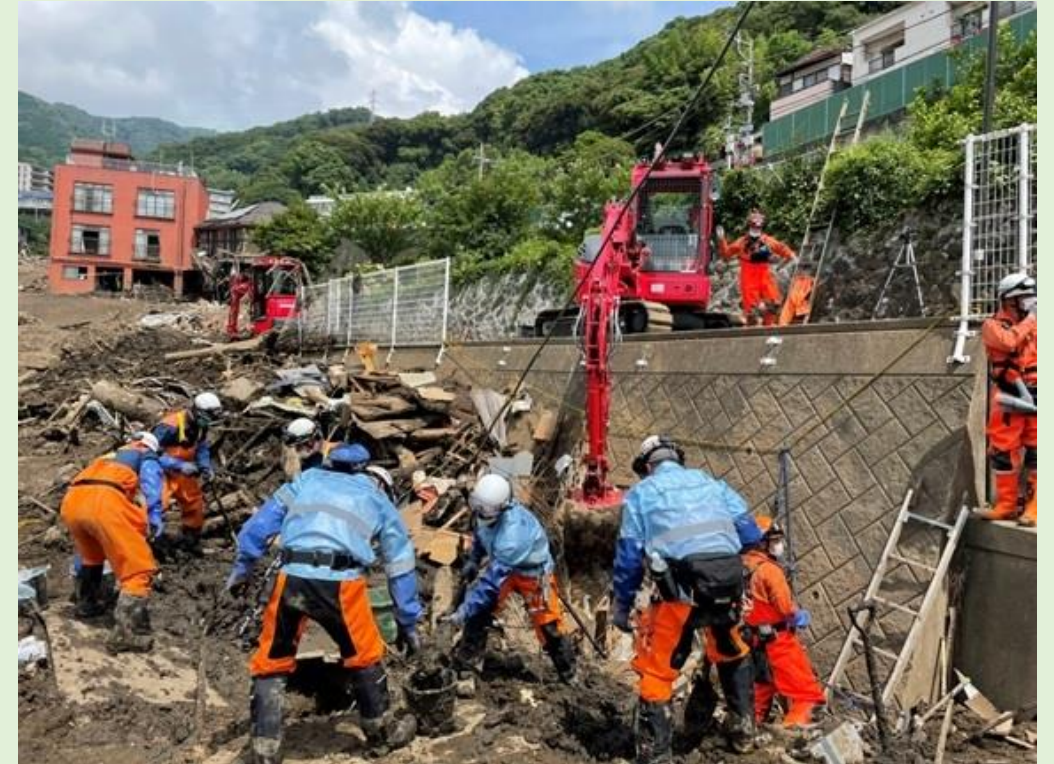
伊豆山の土石流（熱海市）令和3年7月
